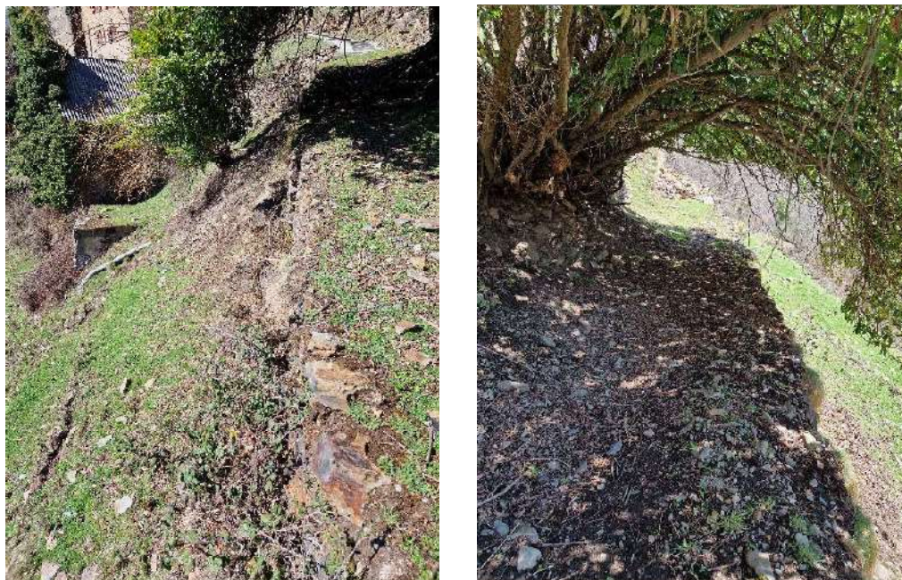
Imatge 5. Murs de pedra seca que requereixen consolidació i reparació. Pas sota arbre sobrecregut que en redueix i incomoda el pas.
